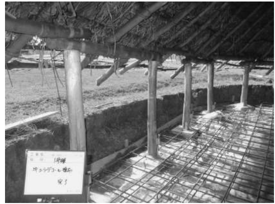
屋根ジャッキアップ、茅葺下部撤去、土間・周堤掘削、鉄筋設置、ゲヤ柱交換・防腐処理など (1号棟)
