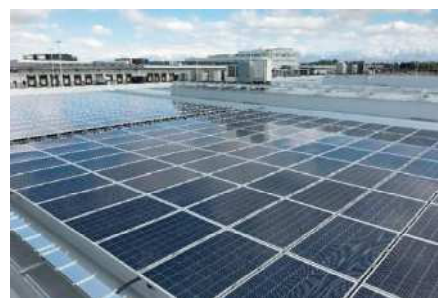
太陽光発電設備
