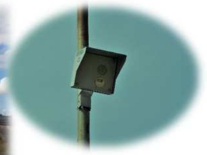
凧見橋放火監視機器設置状況
