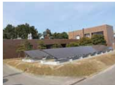
水質管理センター 太陽光発電設備
