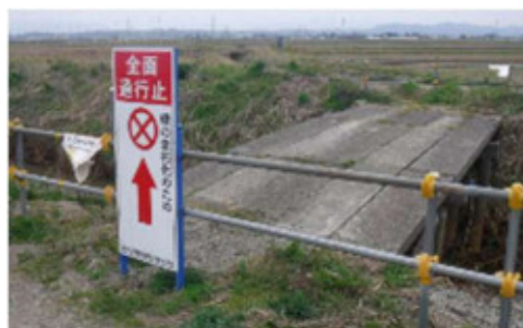
通行止めになってしまった橋
