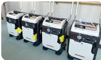
ガスボンベ式発電機4台
