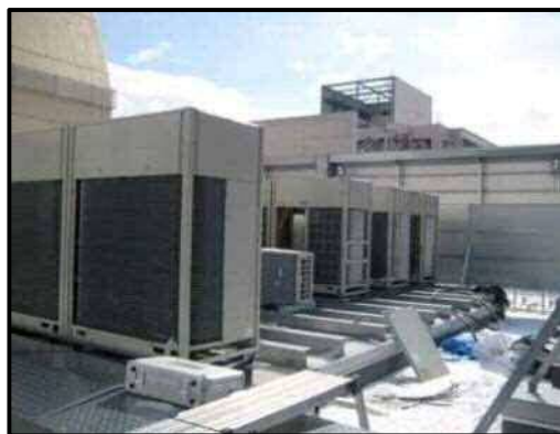
【写真7】屋上室外機
