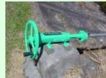
ゲート、バルブの更新
